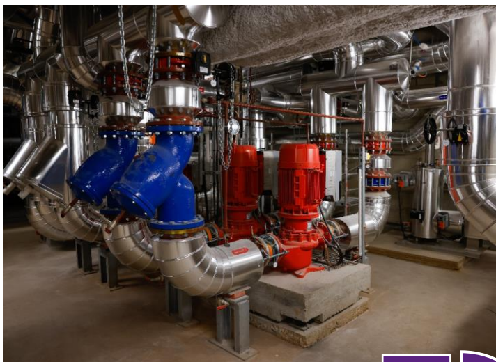
Géothermie (Issy Coeur de Ville)
